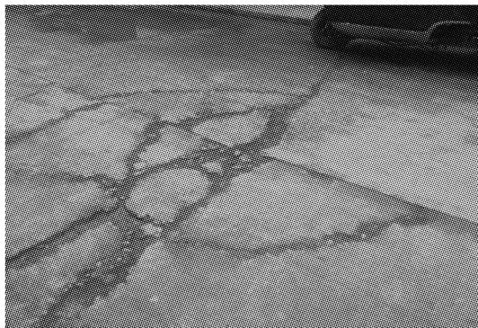
图 1 现状路面破损情况
